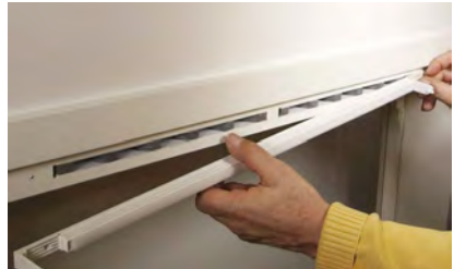
Ilmanottokanavat suodatinkehksen takana
